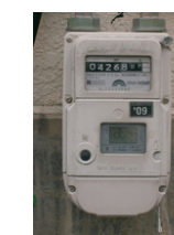
ガスメーター写真
